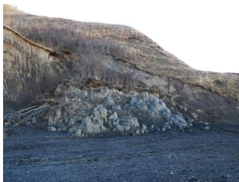
Рисунок 3 – Оползень нагорного откоса площадки под строительство (уч. 1). Высота стенки в левой стороне снимка более 4 м. (фото И.М. Васькова, 9.11.2023г.)
